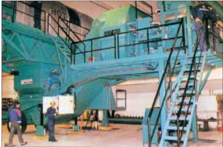
Hot Mix -kuumamassa-asema valmiina tehtaalla.
