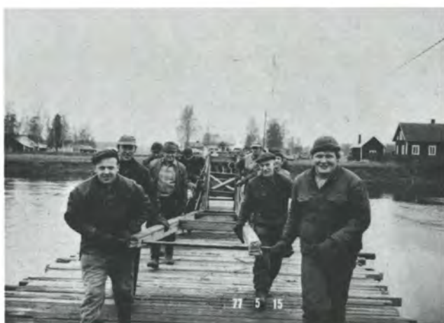
"Hiki-päin, mutta hausalla mielellä aina he puuhailivat". (A. Kivi: Seitsemän veljestä) Sillan purku aloitettiin keskeltä jokea ja tietenkin kilpailtiin siitä, kumpi puoli oli ensi purettuna. Kokoaminen jäidenlähdön jälkeen aloitettiin kummaltakin rannalta.
