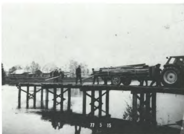
Silta oli purettava keväisin jäidenlähdön ajaksi. Purkutyö vaati runsaasti työväkeä, mutta sitä löytyi. Kaiteet on purettu, kansilankut kerätään kärryille.
