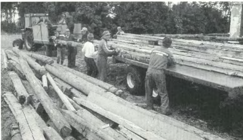
Talo on monien vaiheiden jälkeen tullut purettua ja puita ollaan siirtämässä ja lastaamassa Haapalan Ilmon kärryille. Kökössä oli mukana kymmenen traktoria ja kuorma-auto. Kaikille tuli kaksi kuormaa.
